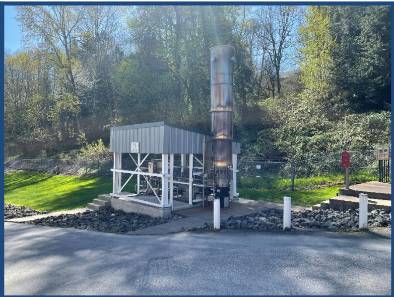
Newer Waste Gas Burner (Varec)
